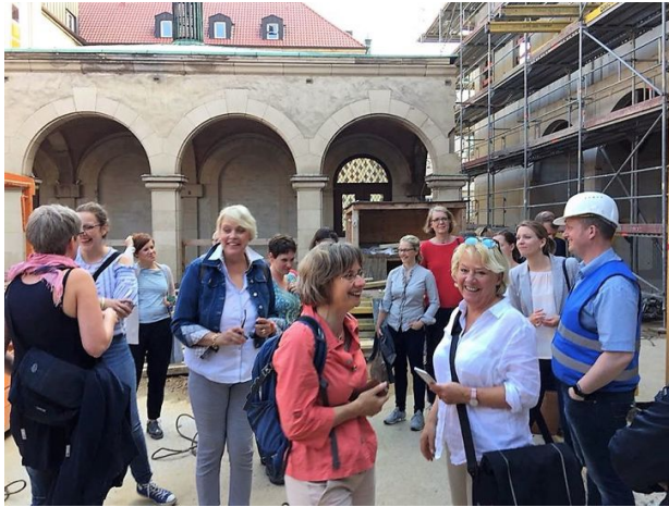
Die „Immofrauen“ waren begeistert von der Baustellenführung durch die Clemensbögen an der Klosterstraße.
